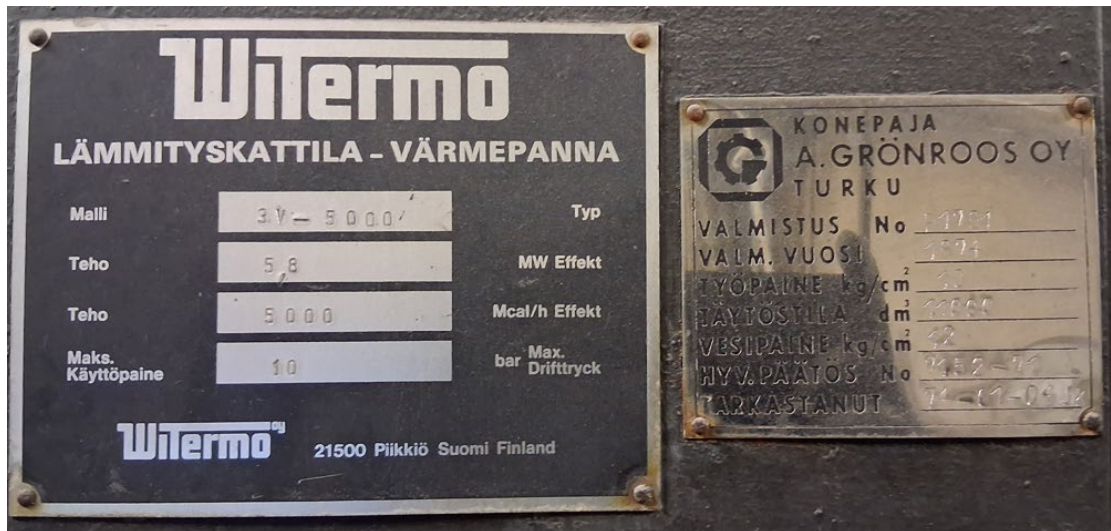
Kuva 2. 5,8 MW kattilan tyyppikilpi
