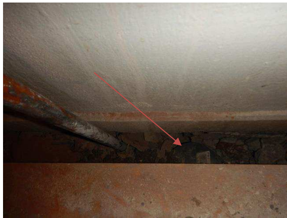
Kuva 9. Putkinousun tarkastusluukusta havaittiin käytöstä poistettu tulpattu viemäri. Liitoksen tiiveys tulee varmistaa.
