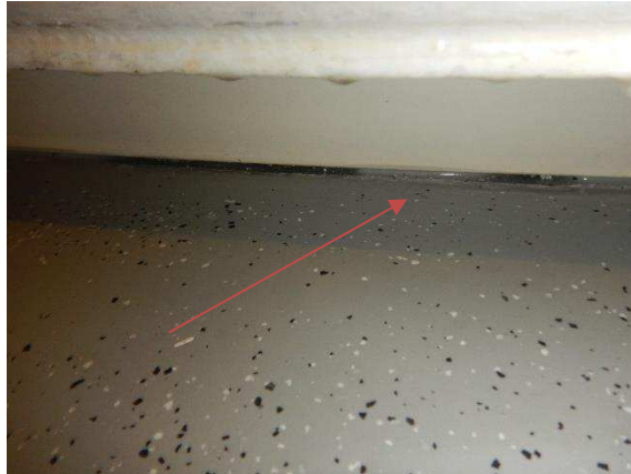
Kuva 7. Tutkittuihin tiloihin oli tehty tiivistyskorjaukset. Tiivistyksissä havaittiin aistinvaraisesti ilmavuotoa puutteita, joista osa oli korjattu näytteenottopäivään mennessä.
