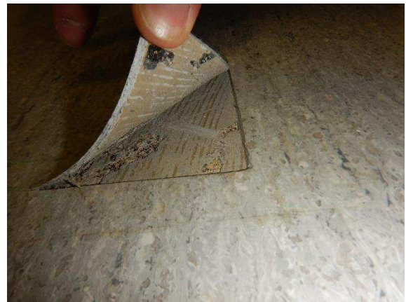
Kuva 10. Muovimaton alla havaittiin osittain poistettu mahdollisesti asbestia sisältävä musta liima.
