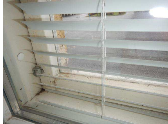
Kuva 8. Ikkunat olivat osin huonokuntoisia. Näytteenottopäivänä ikkunan välissä havaittiin pientä viistosateesta aiheutunutta vesivuotoa.
